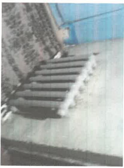
Термографический снимок 3. Радиатор отопления. (1 этаж). Недостаточная проходимость отдельных секций радиатора отопления.
